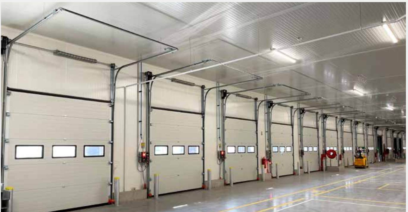
77 puertas seccionales en almacén refrigerado.
