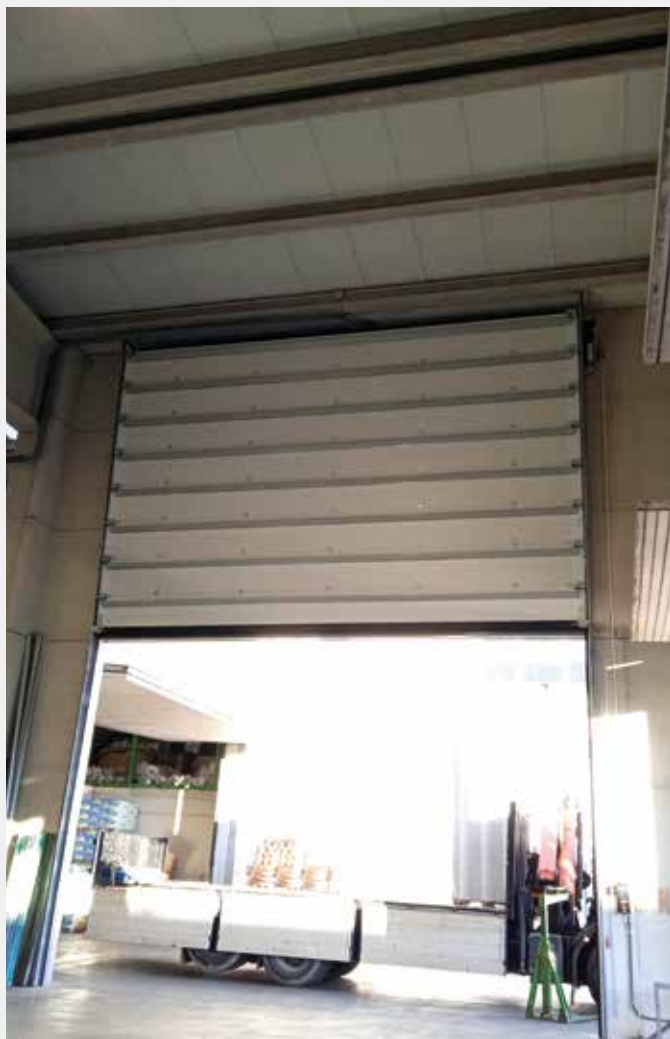
Puerta seccional para empresa proveedora de materiales para la construcción.
