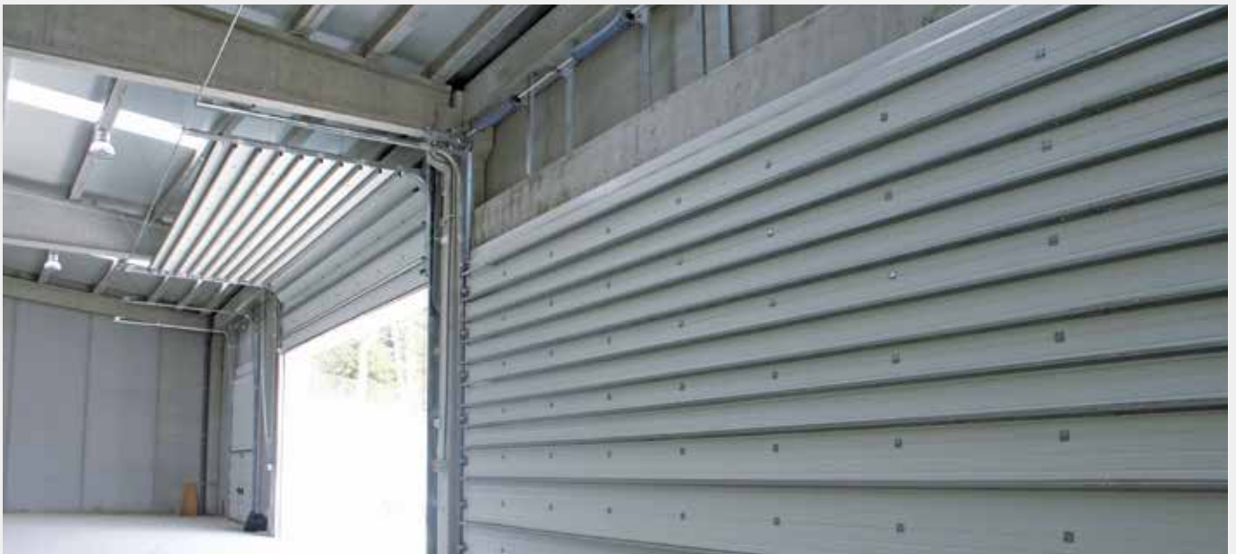
Vista interior de puertas seccionales en nave industrial.
