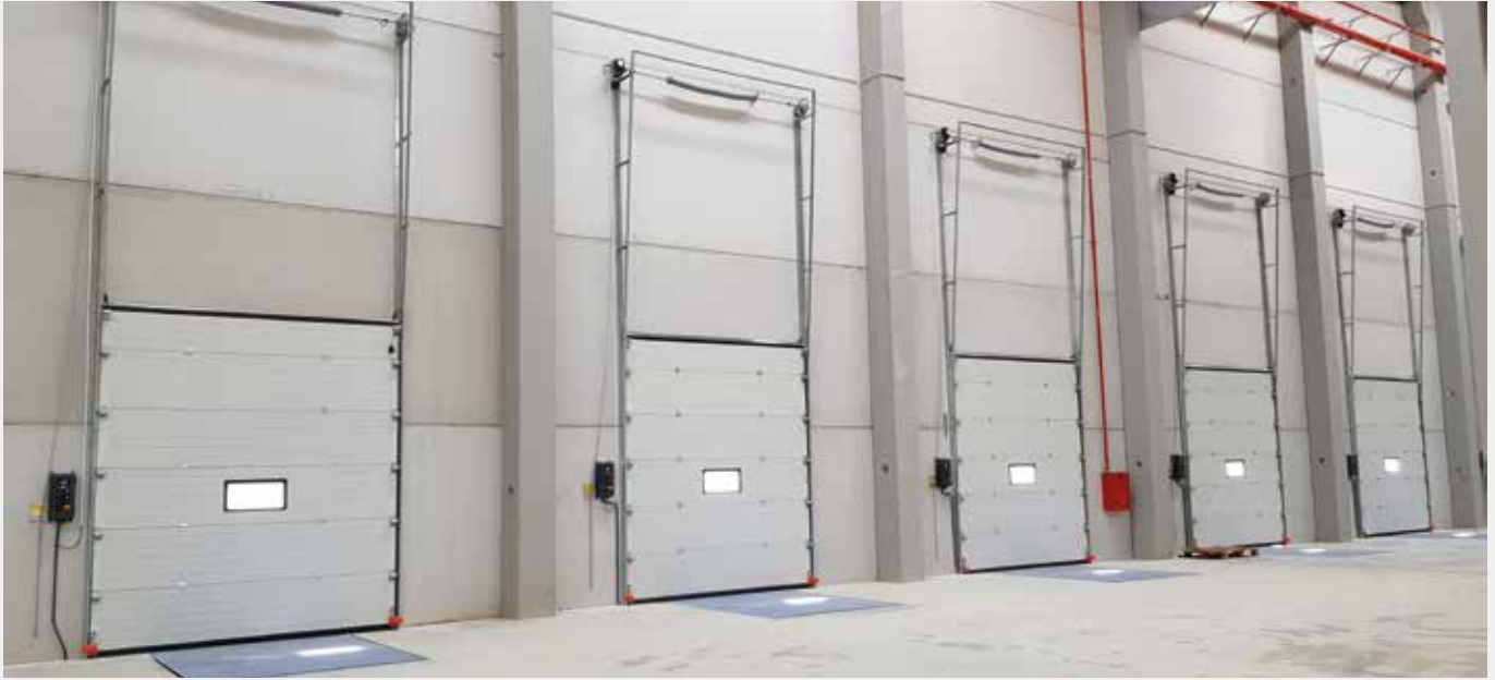
Muelles de carga con puerta seccional Sandwich para empresa de transportes.
