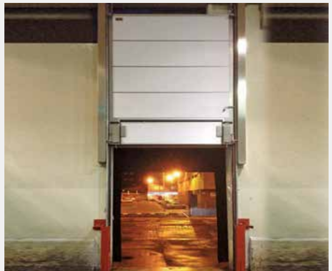
Fiber-Secc® con panel inferior autorreparable en lonja de pescados.
