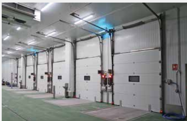
Puertas seccionales en varios muelles de carga.
