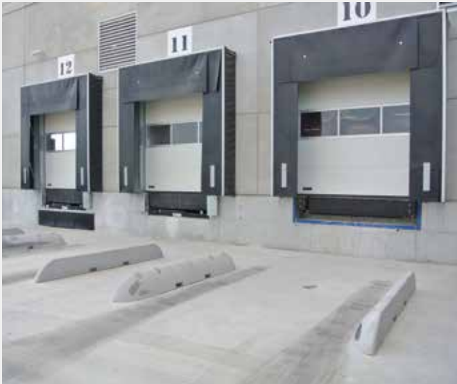
Vista exterior muelles con puertas ECO-DOCK con panel acristalado.
