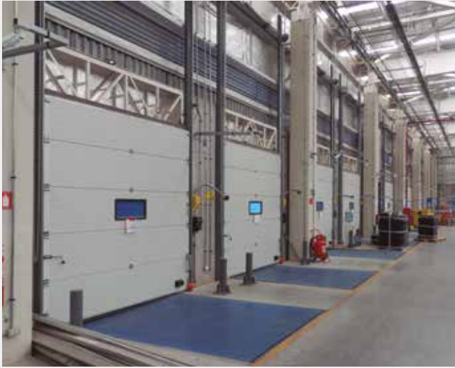
Puertas seccionales, rampas niveladoras Hydra y luces Verslight en muelle de carga.
