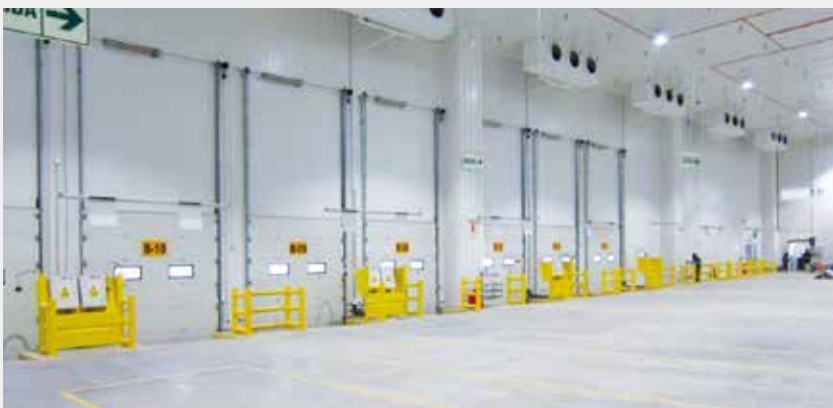
Vista interior de muelle de carga Isoperfect .
