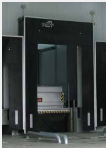
Mesa elevadora instalada en el interior con pasarela de aluminio
