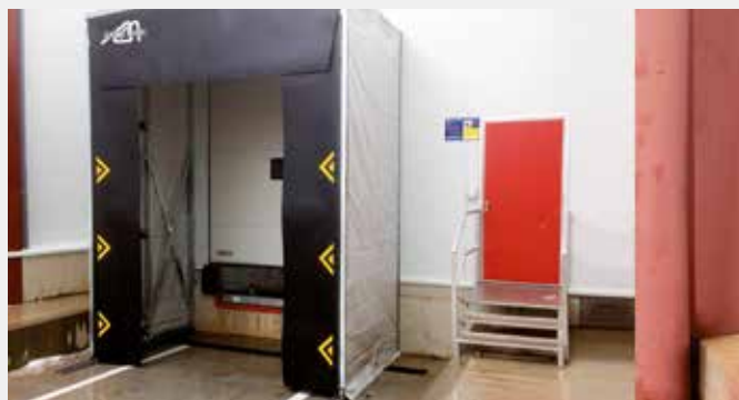
Abrigo extensible en punto de carga.
