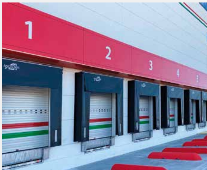
Rampa Hidra con puertas enrollables con mirillas.
