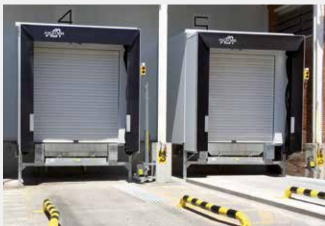
Muelle logístico refrigerado con puertas enrollables Mirtherm.
