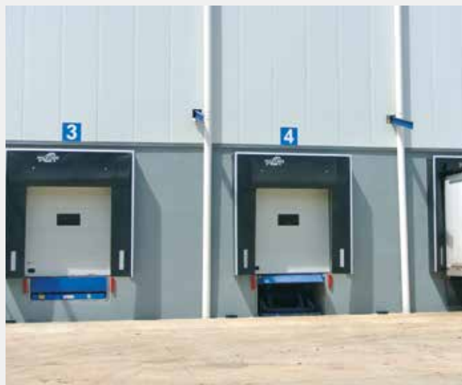
Rampa HIDRA y mesa elevadora muelle de carga .
